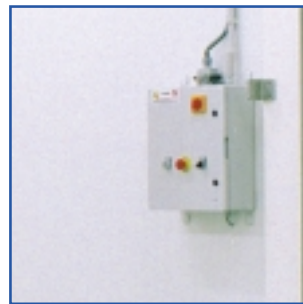
Quadro elettrico Control panel Schaltkasten
