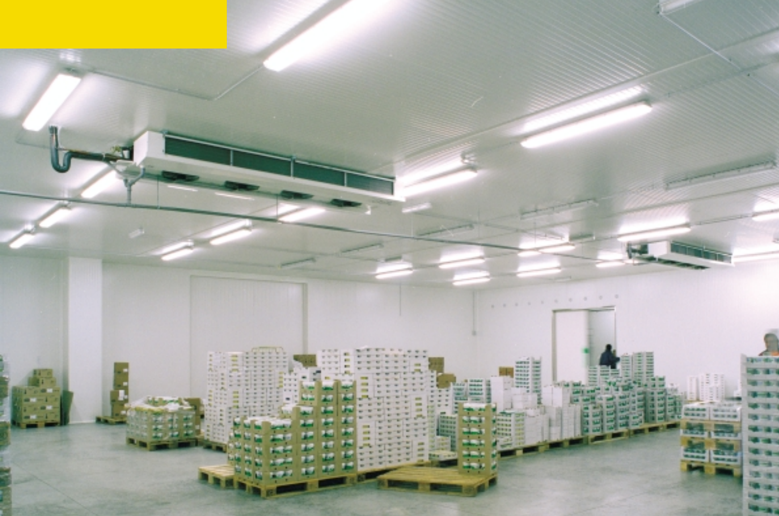
Settore logistico, Cella di conservazione Logistics sector, Storage coldroom Logistik, Konservierungszelle
